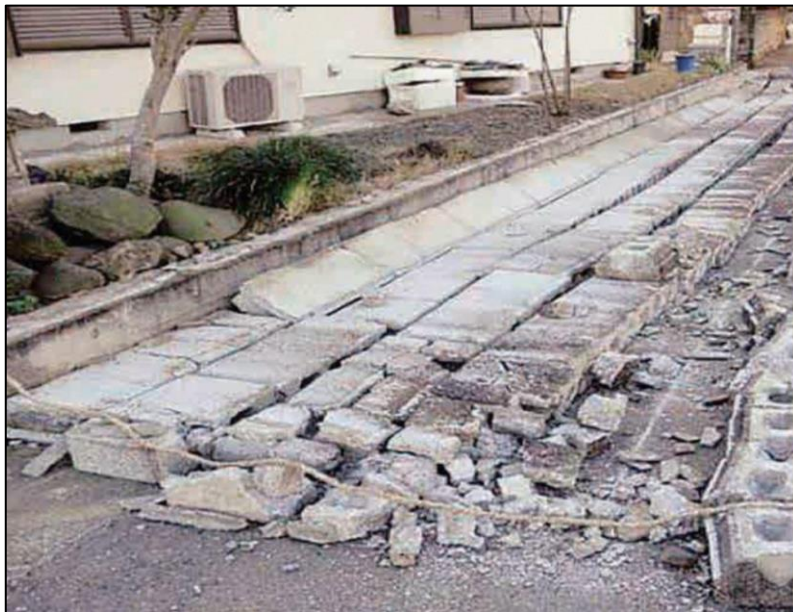
▲ブロック塀倒壊の様子
