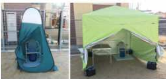
マンホールトイレ (3 基のうち 1 基はスペースを確保し、多目的に活用できる用工夫)
