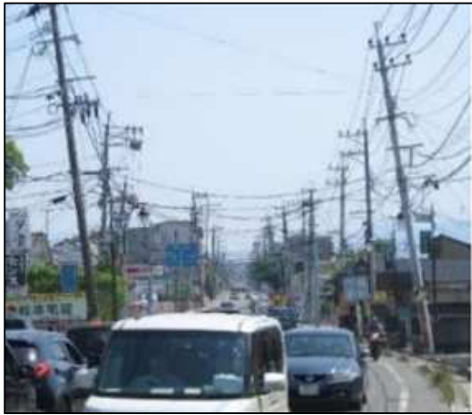
電柱の傾斜(県道 28 号(緊急輸送道路))
