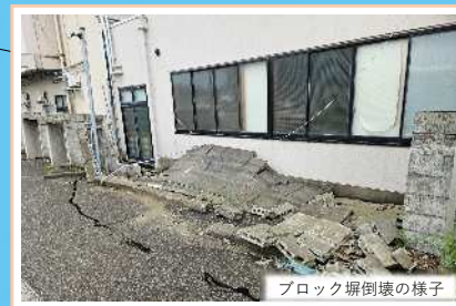
ブロック塀倒壊の様子
