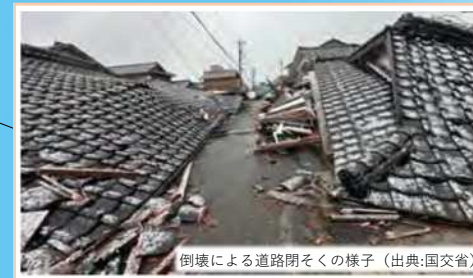
倒壊による道路閉鎖の様子 (出典:国交省)
