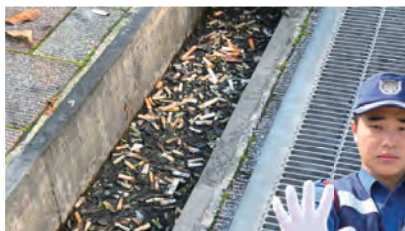
▲区内喫煙所周辺の排水溝
