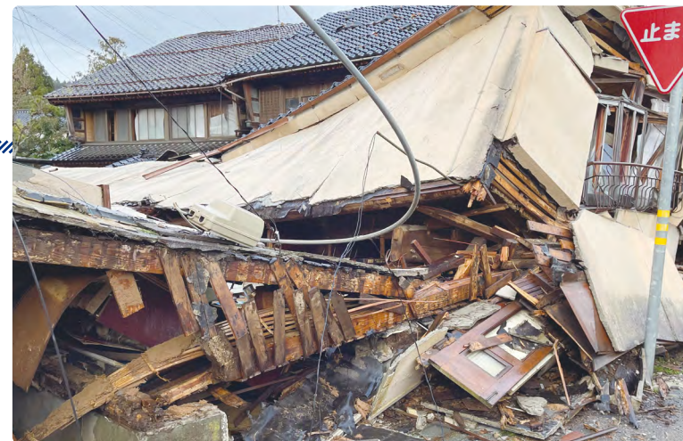
▲令和6年能登半島地震で亡くなった方の約4割が倒壊した建物の下敷きになったことなどによる「圧死」でした。また、「2000年基準」を満たさない木造住宅が数多く倒壊しました。
