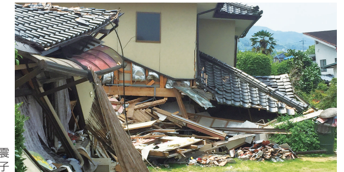
平成28年の熊本地震による被害の様子
