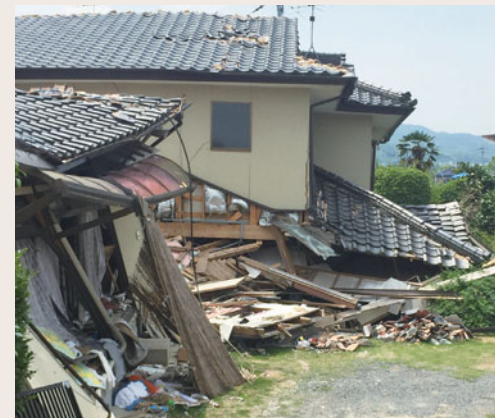
熊本地震による被害の様子
