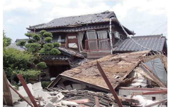
▲熊本地震による被害の様子
