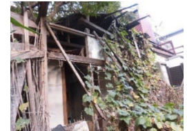
▲適正に管理されていない空き家
