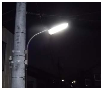
（省エネルギー型街路灯）
