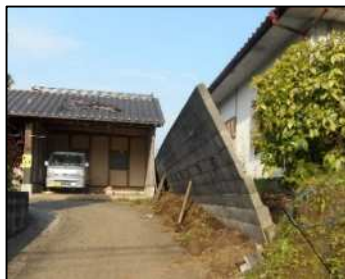
傾いたブロック塀 (平成 28 年熊本地震)
