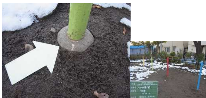
写真1 ハザード3の例 基礎の露出
