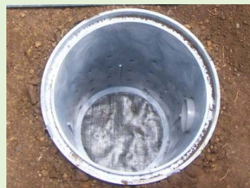
雨水浸透施設（浸透ます）
