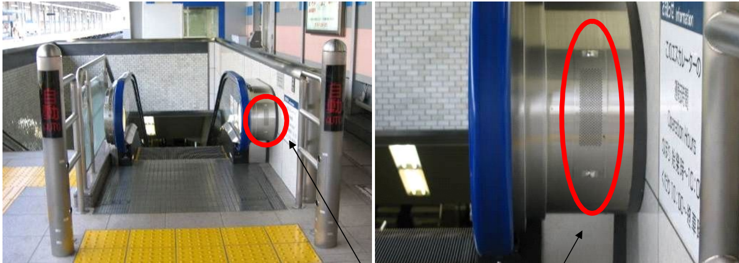
エスカレーター内蔵スピーカーの例
