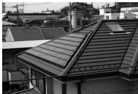
太陽光発電設備
