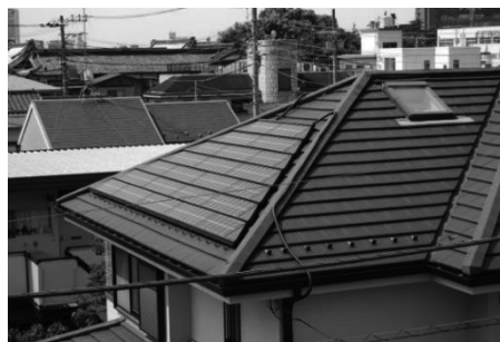
太陽光発電設備
