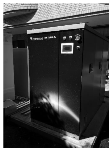
田柄特別養護老人ホームに設置した超高効率燃料電池システム
