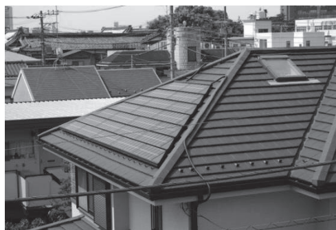
太陽光発電設備
