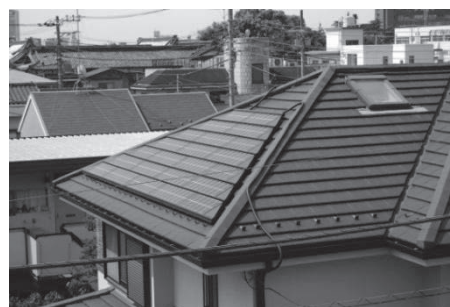
太陽光発電設備
