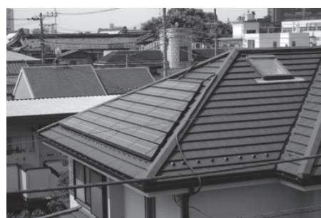
太陽光発電設備
