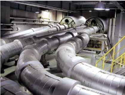
ごみ管路収集輸送システム （有明清掃工場）
