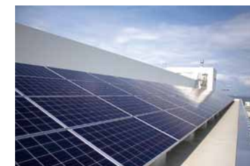
太陽光発電パネル（大田清掃工場）
