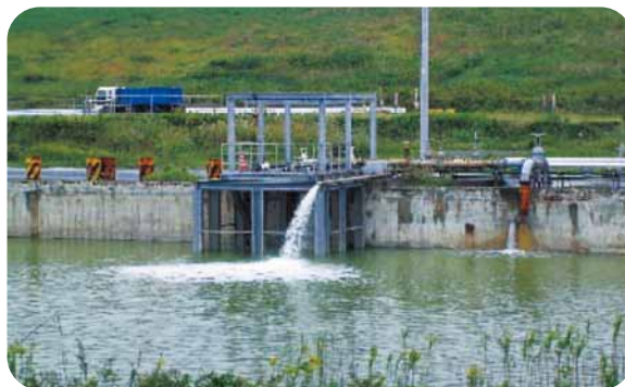
ポンプ井（集水池）
