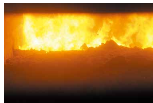
焼却炉内部の様子（北清掃工場）
