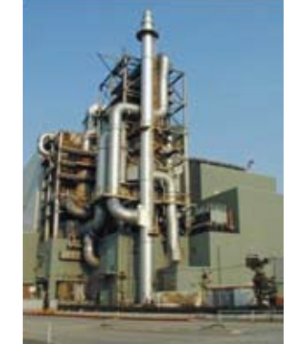
破碎ごみ処理施設
