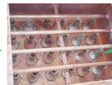
ろ過式集じん器内部（有明清掃工場）
