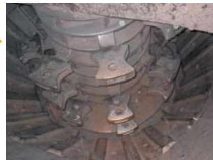
回転式破碎機(縦軸)の内部
