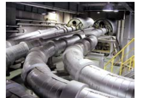
ごみ管路収集輸送システム (有明清掃工場)
