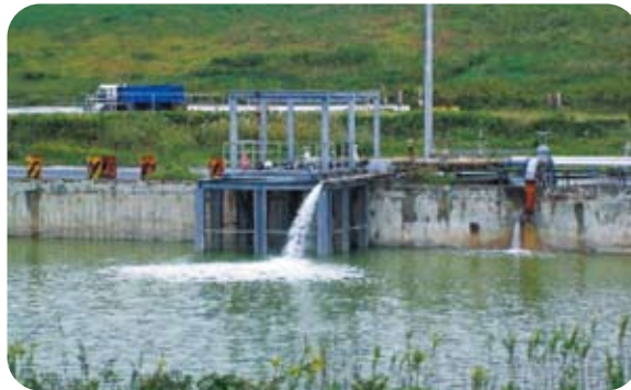
ポンプ井 (集水池)
