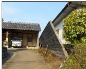
傾いたブロック塀 (平成 28 年熊本地震)
