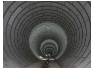
環状七号線地下広域調節池 (石神井川区間事業中)
