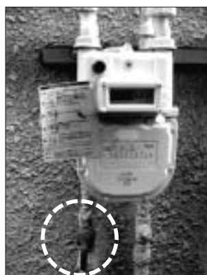
屋外のガスの元栓
