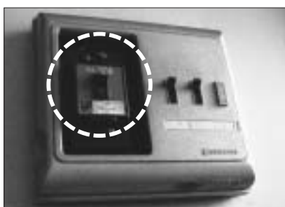
電気のブレーカー
