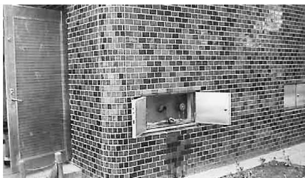
給水拠点（応急給水槽、給水所） 東京都水道局の非常災害用給水設備
