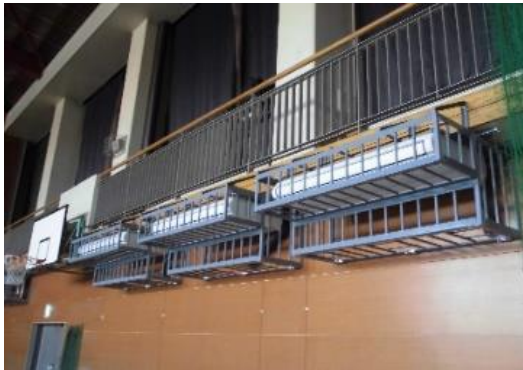
▲体育館の空調設備
