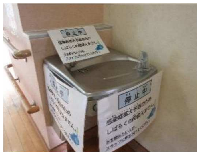
< 冷水機の使用禁止 >
