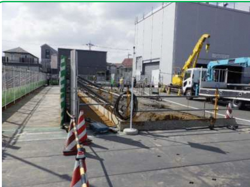
練馬区有通路33-55号線における 路面覆工施工状況(掘削状況)(R4.9月)
