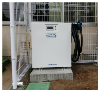
設置した外部電力供給設備
