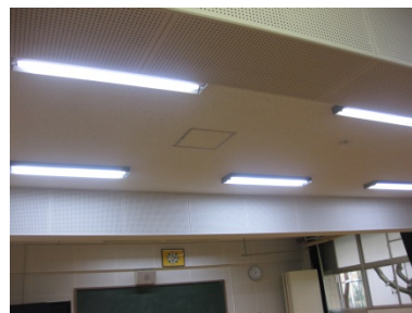
外部電力供給設備からの給電で点灯した蛍光灯（視聴覚室）
