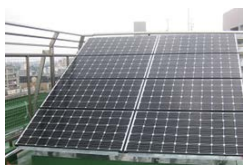
太陽光発電(区役所西庁舎屋上)
