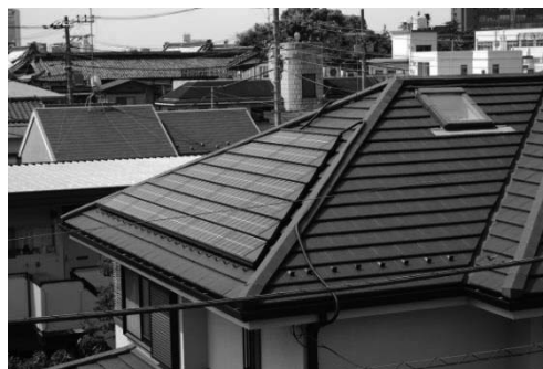
太陽光発電設備
